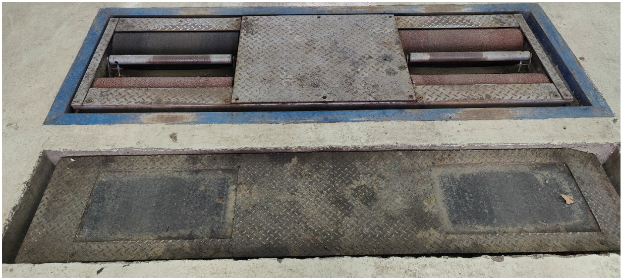
2. Stand cu role pentru determinarea eficienței sistemului de franare a automobilelor dotat cu cantar pentru fiecare axa
